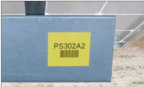
太陽光パネル
